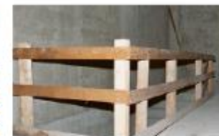
2 Risque de chute à l'intérieur d'un ouvrage (p. ex. ouverture pour cage d'escaliers).
