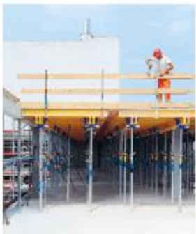
Règle 1 Sécuriser les zones à risque de chute.
