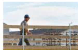
1 Risque de chute sur un coffrage de dalle (p. ex. interruptions de bétonnage).
