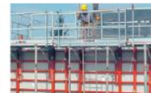
3 Risque de chute sur une plateforme de bétonnage.
